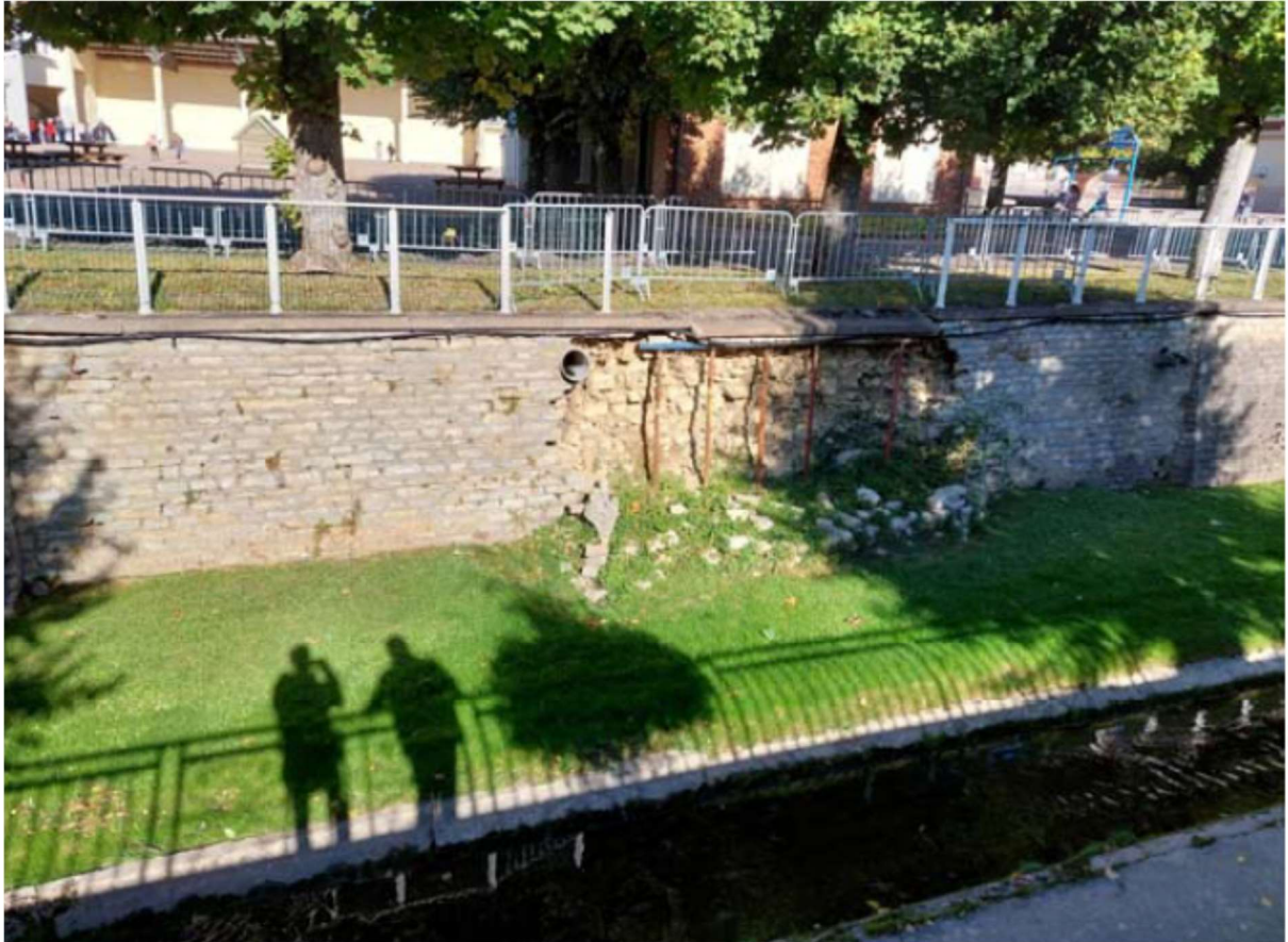
Vue sur le mur de berge écroulé depuis la rue du Maréchal Joffre – Le petit Vair est canalisé en partie centrale
